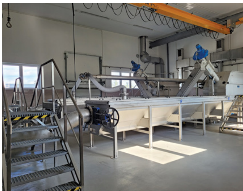
Fot. 5. Sito-piaskownik w oczyszczalni ścieków „Zamienie”
