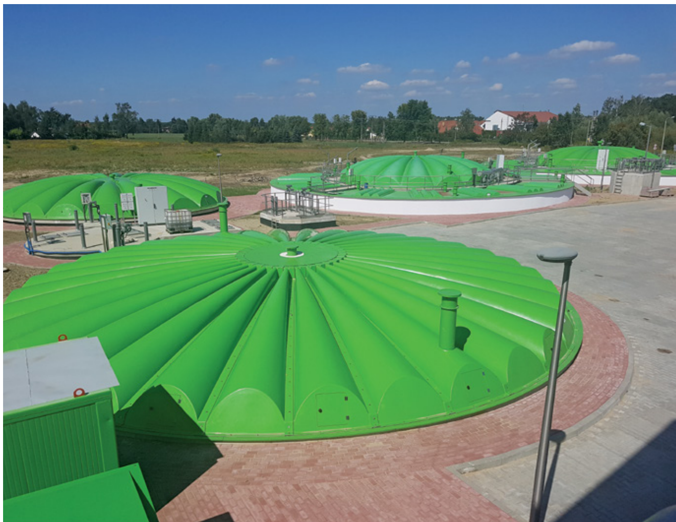
Fot. 7. Oczyszczalnia ścieków „Łazy”
