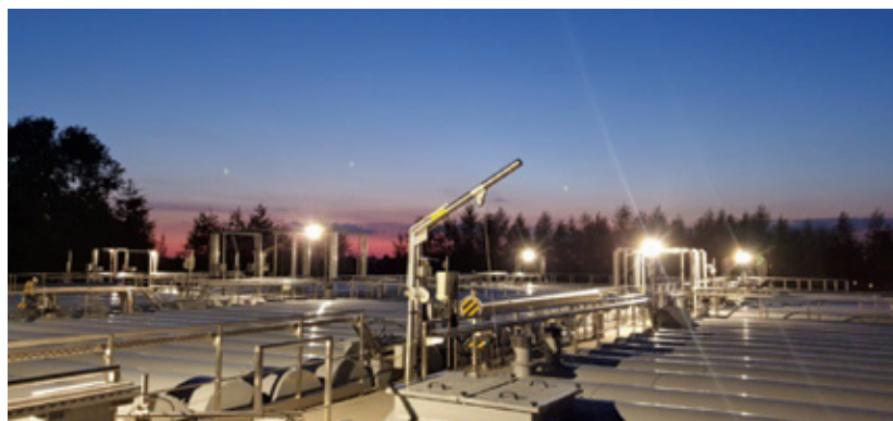
Fot. 4. Komory biologiczne w oczyszczalni ścieków „Zamienie”
