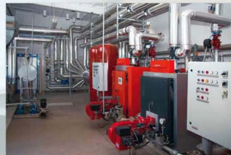
Kotłownia olejowo-gazowa, oczyszczalnia ścieków Fordon w Bydgoszczy.
