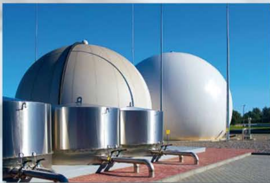
Zbiorniki biogazu wraz z odsiarczalniami, oczyszczalnia ścieków Fordon w Bydgoszczy.
