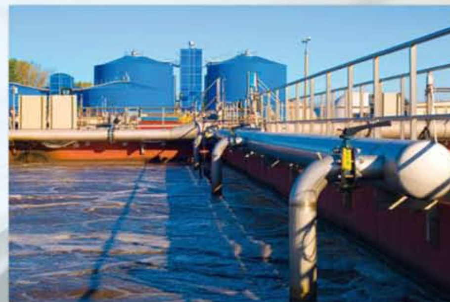
Reaktor biologiczny, oczyszczalni ścieków Fordon w Bydgoszczy.
