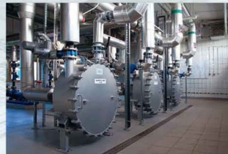
Podgrzewanie osadu - wymienniki ciepła, oczyszczalnia ścieków Fordon w Bydgoszczy.
